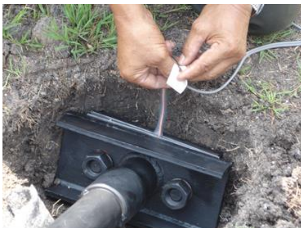
รูปที่ 78 แสดงการเชื่อมต่ออุปกรณ์ควบคุมการจุดระเบิดด้วยไฟฟ้าเข้ากับตัวท่อยิง
